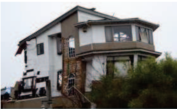
石川県七尾市和倉町周辺 傾いている家
