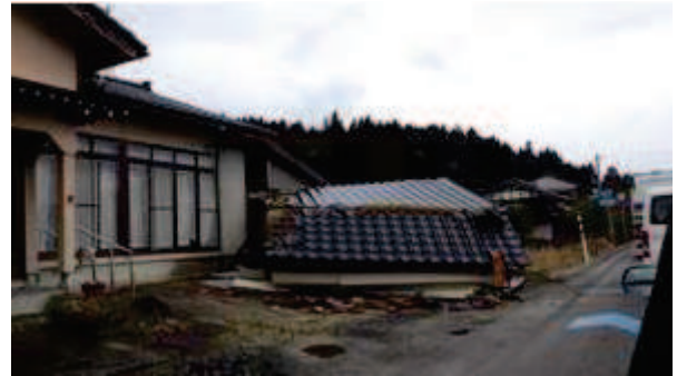
石川県七尾市穴水周辺 潰れた倉庫(車庫)
